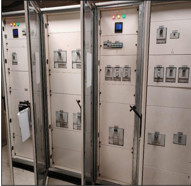
Elektrik Tesisatı, Topraklama ve Paratoner Sistemleri Periyodik Kontrolleri yapılmıştır
