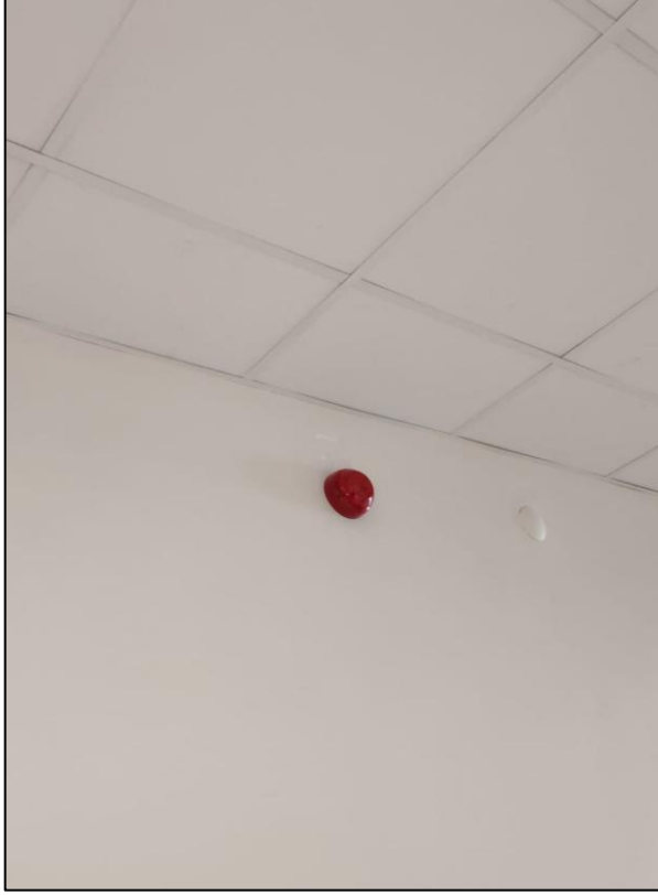
Yangın İhbar Sistemi Sesli Yönlendirme
