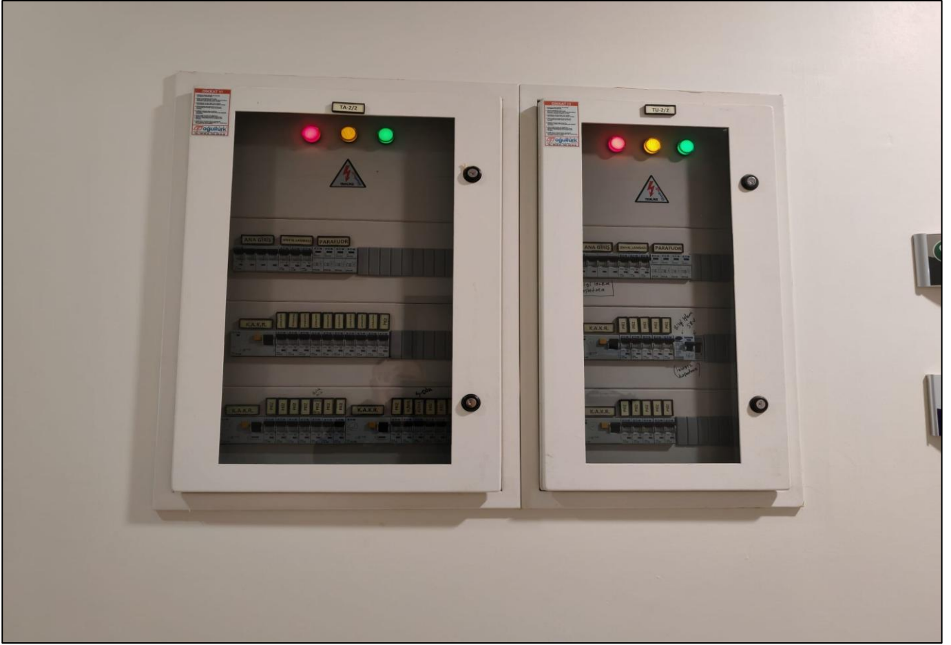
Elektrik Tesisatı, Topraklama ve Paratoner Sistemleri Periyodik Kontrolleri
