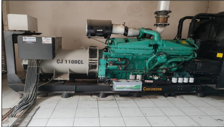
Jeneratör Yıllık Periyodik Bakımının Yapılması
